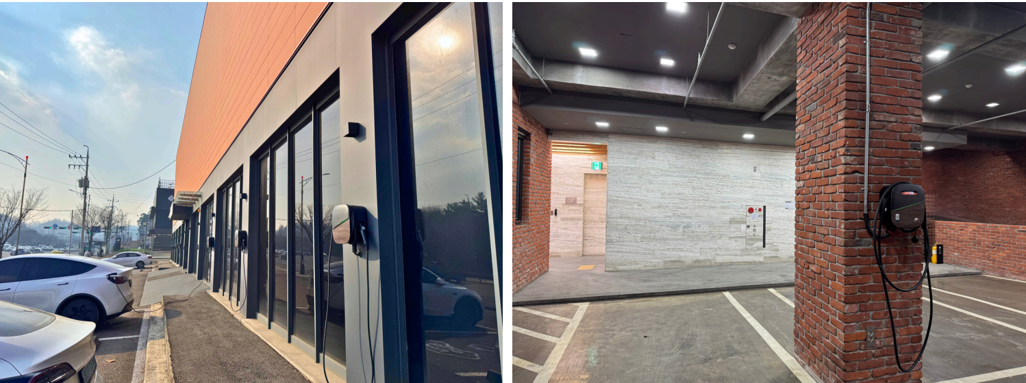
[ 그리드위즈 주차장 내 전기차 충전기 ]
